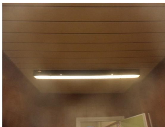
Figura 4.13 - Particolare dei corpi illuminanti
