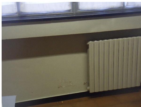
Figura 4.6 – Particolare dei radiatori
