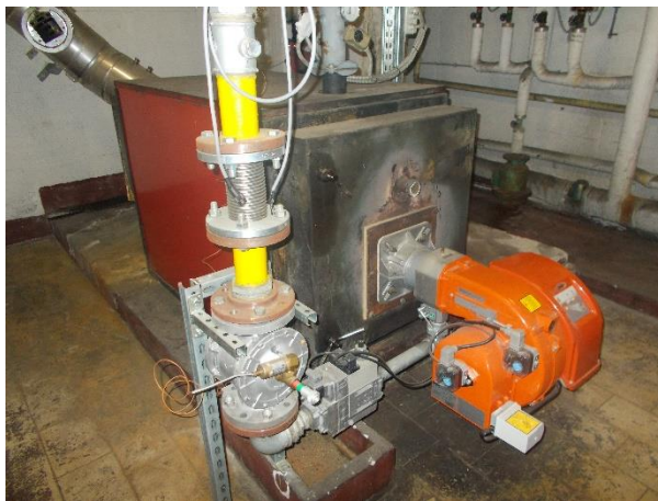
Figura 4.11 - Particolare del generatore
