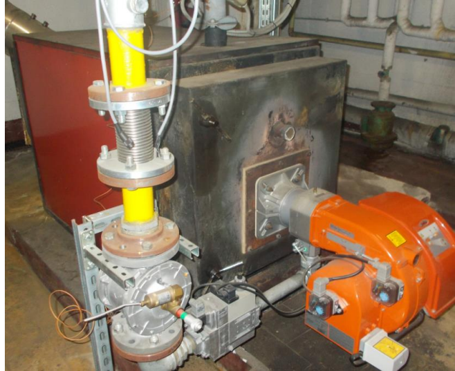
Figura 8.6 – Particolare della caldaia
